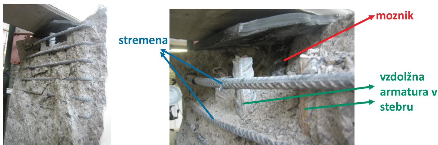
Slika 5. Globalne poškodbe in globalna porušitev mozničnega stika.
