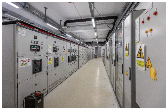
Slika 9. Elektroomare v elektroobjektu, junij 2023.
